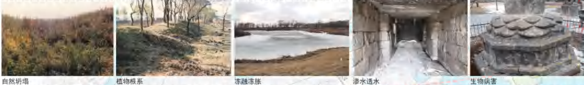
自然坍塌 植物根系 冻融冻胀 渗水透水 生物病害
